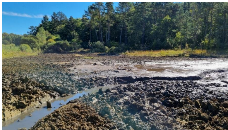
Figure 15 : photos avant, pendant et après travaux de l'effacement de l'étang Carillon à Villars-Santenoge
